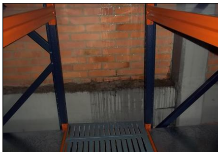
Humedad en áreas de trabajo en estanterías en Bodega Rosa Zárate
